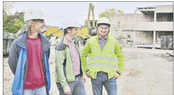
Geologe Stefan Wozak, Christoph Braun vom Fachbereich Gebäudemanagement und Daniel Single von der Abbruchfirma Libare (von links) sind mit Verlauf und Fortgang der Abbrucharbeiten zufrieden.
