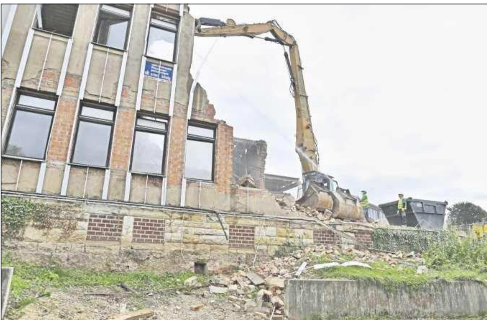
Der Blick auf das untere (nördliche) Ende des Burg-Gymnasiums, dessen Mauerreste nach und nach abgeknabbert werden.
