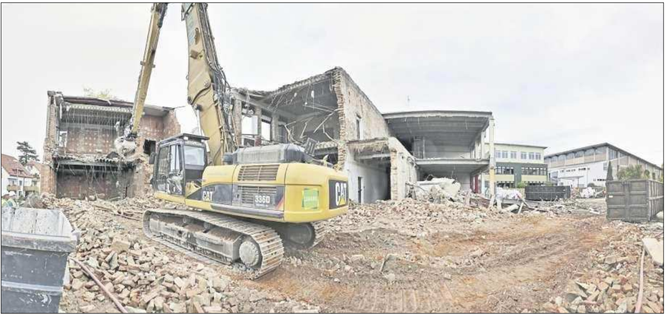
Stück für Stück frisst der Bagger, der sich von Norden nach Süden voranarbeitet, aus dem alten Burg-Gymnasium heraus. Der grüne Erweiterungsbau (im Hintergrund) bleibt stehen.
